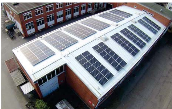
Abb. 66: Photovoltaikanlagen auf einem TF-Gebäude
