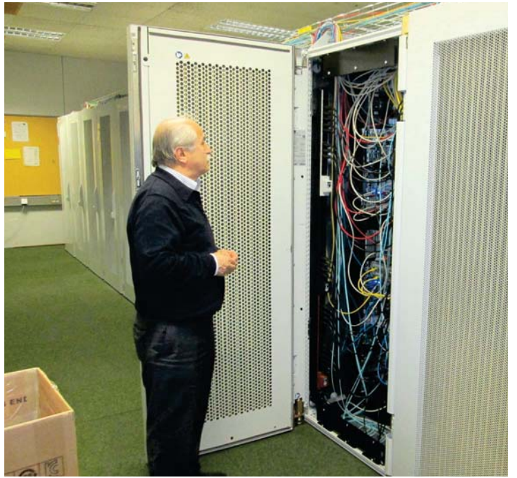
Abb. 48: Einhausung der Server-Racks
